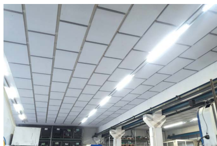
Raumakustische Maßnahme: Wand oder Decken mit schallabsorbierenden Materialien verkleidet.
